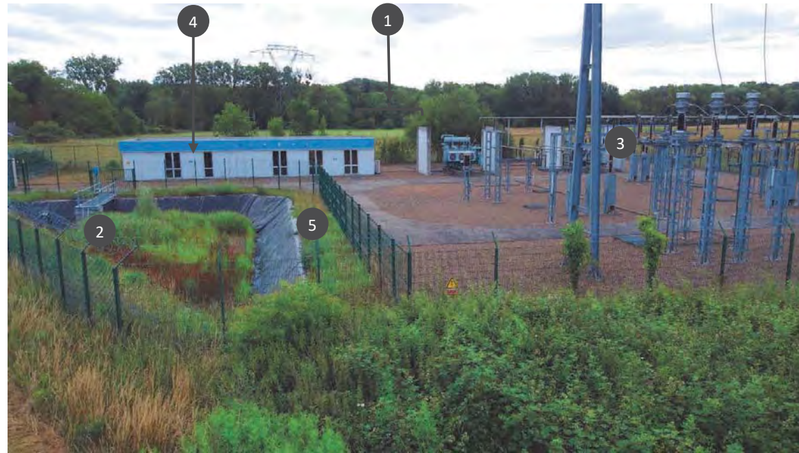
Photographie du poste source de Brenouille existant Source : PHOTOSOL
